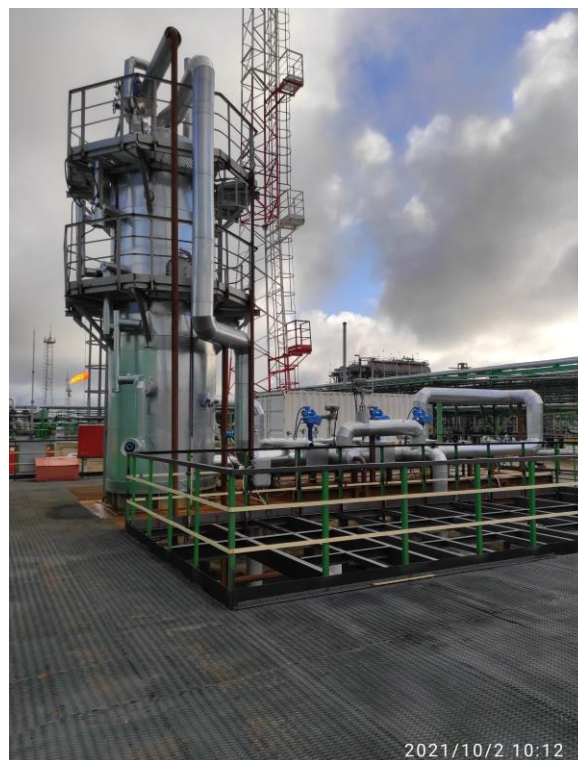
Рис. 7. Абсорбер каталитической сероочистки на площадке ОПР
