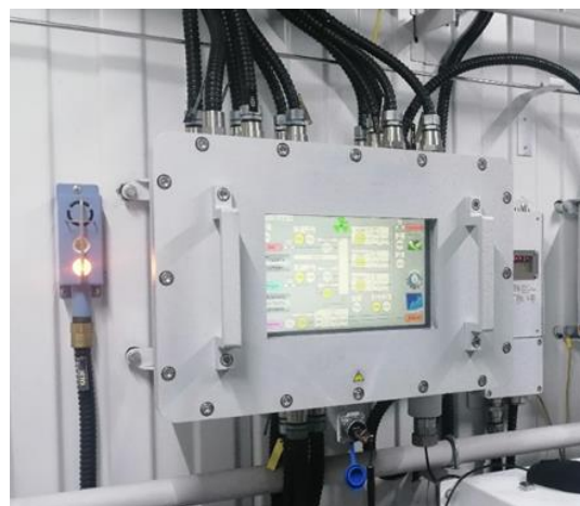
Рис. 6. Панель управления установкой сероочистки газа во взрывозащищенном исполнении
