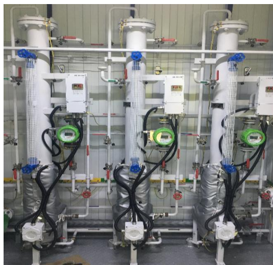
Рис. 5. Основное технологическое оборудование: блок абсорберов каталитической сероочистки
