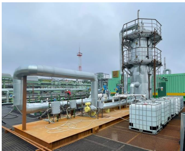
Рис. 9. Арматурный блок установки каталитической сероочистки
