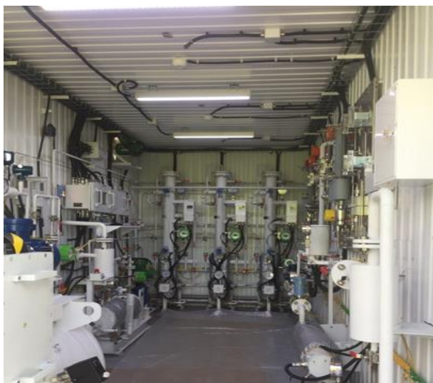
Рис. 3. Общий вид оборудования тестовой мобильной установки сероочистки ПНГ
