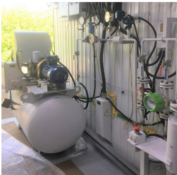
Рис. 4. Система подачи воздуха: воздушный компрессор, ЗРА, КИП
